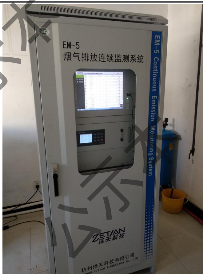
废气在线监测装置
